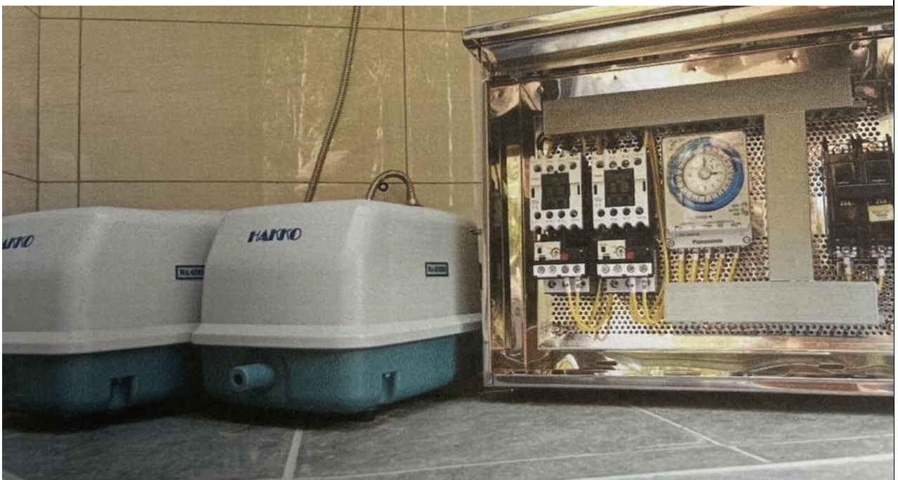
設置 2 組鼓風機及自動化控制箱接電後照片
