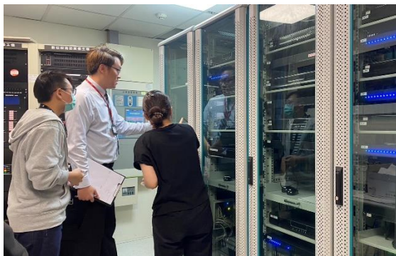
專家現場輔導(機房)
